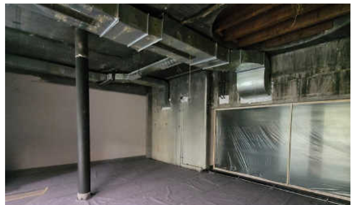
Die verkohlte Decke in der Sauna
